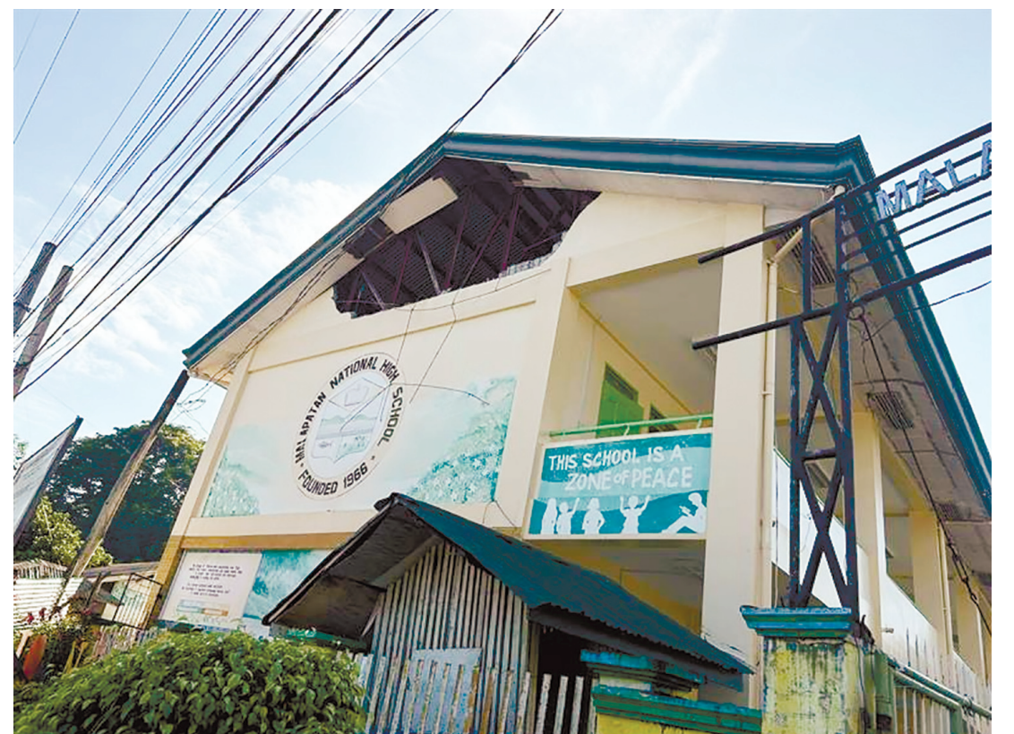
棉蘭佬發生7.8級地震後，沙蘭彥尼省馬拉巴丹國立高中的一棟建築物的部份牆壁和天花板坍塌。高中教室受到影響，而一棟建築物遭受了「主要結構損壞」。該學校的課程仍暫停。
