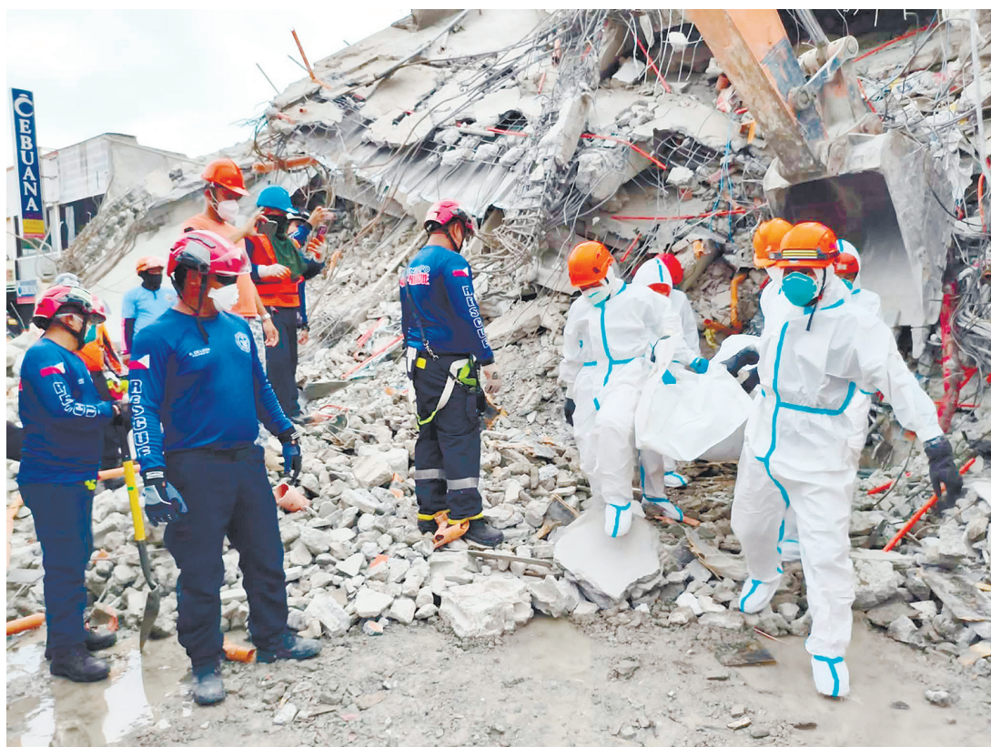
截至昨日下午3點43分，救援人員又從邦邦省紅奚禮示市倒塌的在建建築廢墟中挖出一具遺體。此次悲劇的死亡人數已上升至10人。
